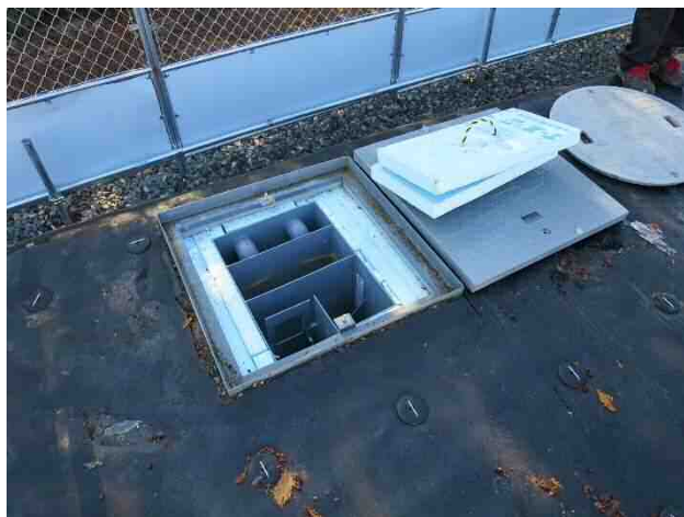
計量槽 (周りと蓋にウレタンフォームで断熱されている)
