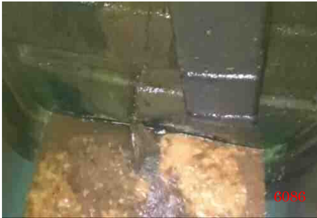
汚泥引抜時の隔壁亀裂と短絡流
