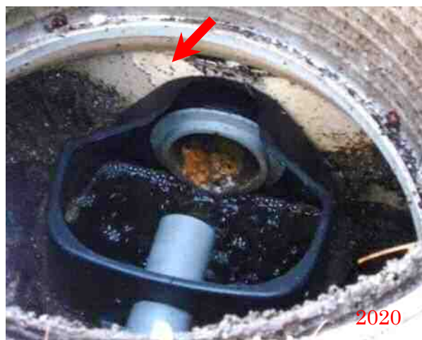
管路接合部付近亀裂
