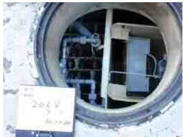
漏水による水位低下（処理槽）
