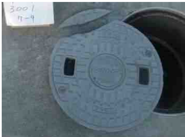
マンホール破損 灯油タンク（400 リットル規模）が倒れ、マンホールを破損。
