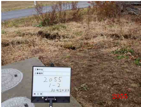
周辺の地割れ
