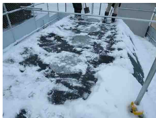
積雪による状況 (浄化槽上部)
