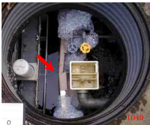
仕切り板変形・破損
