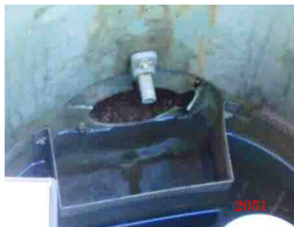
放流口部破損
