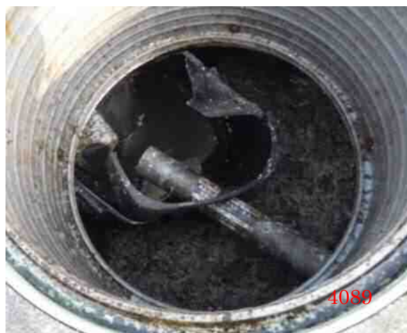
流入バッフル破損
