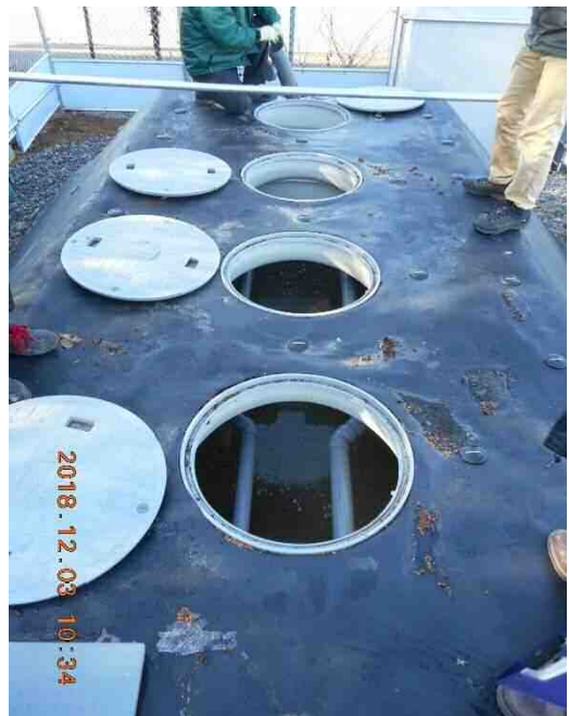
夾雑物除去槽・嫌気ろ床槽（下）から 処理槽（上） (断熱施工はされていない。)
