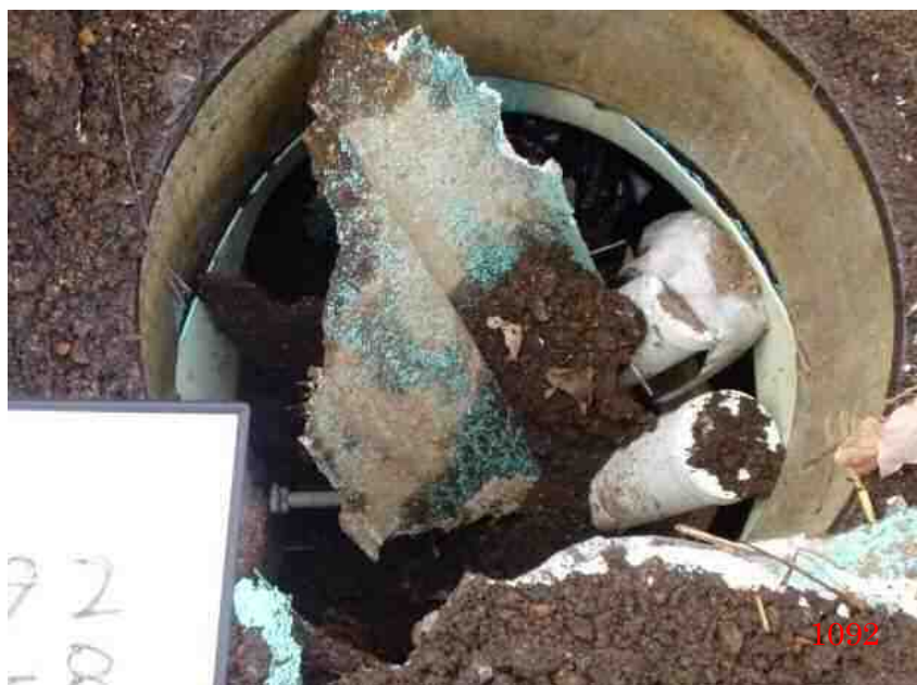
上部 FRP 部材の破損土砂流入
