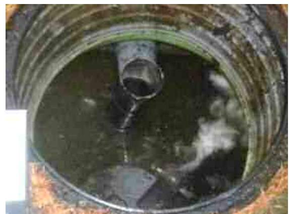
沈殿分離室の水位低下
