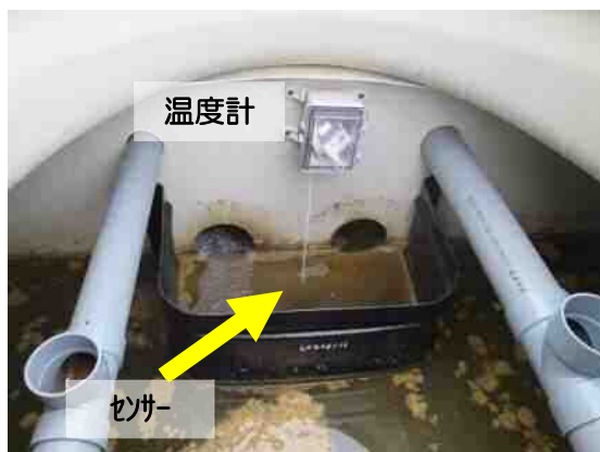
嫌気ろ床槽の水温測定
