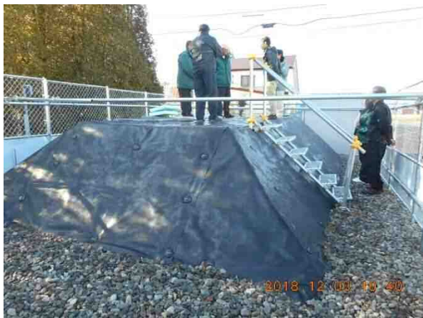
半地下埋設型＋盛土方式の合併処理浄化槽 (盛土表面は黒いゴムシートで覆われている)
