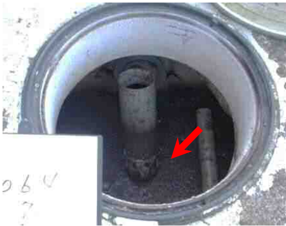
漏水による水位低下（流入側）
