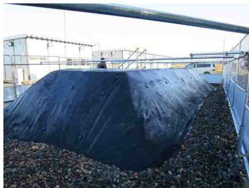
半地下埋設型+盛土による設置状況
