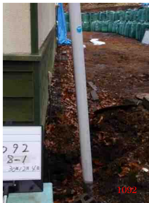
臭突管の傾き、倒壊
