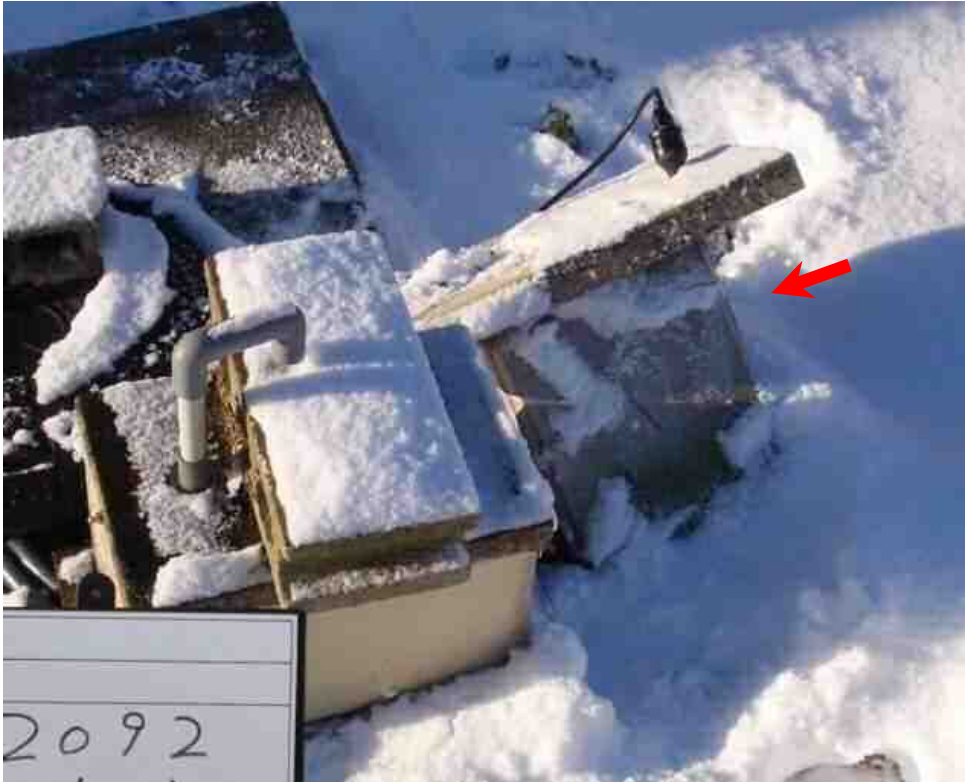
ブロワ土台の傾き
