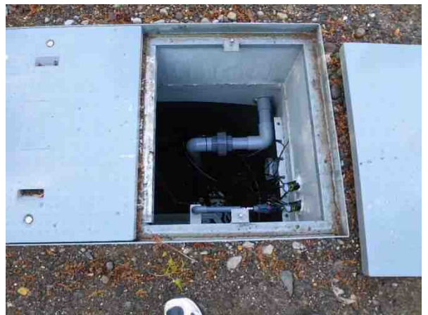
原水ポンプ槽 (左図の手前に地面下に設置されている)
